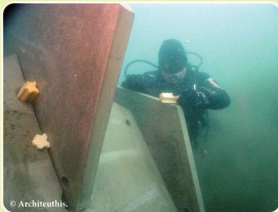
Une installation rondement menée.
